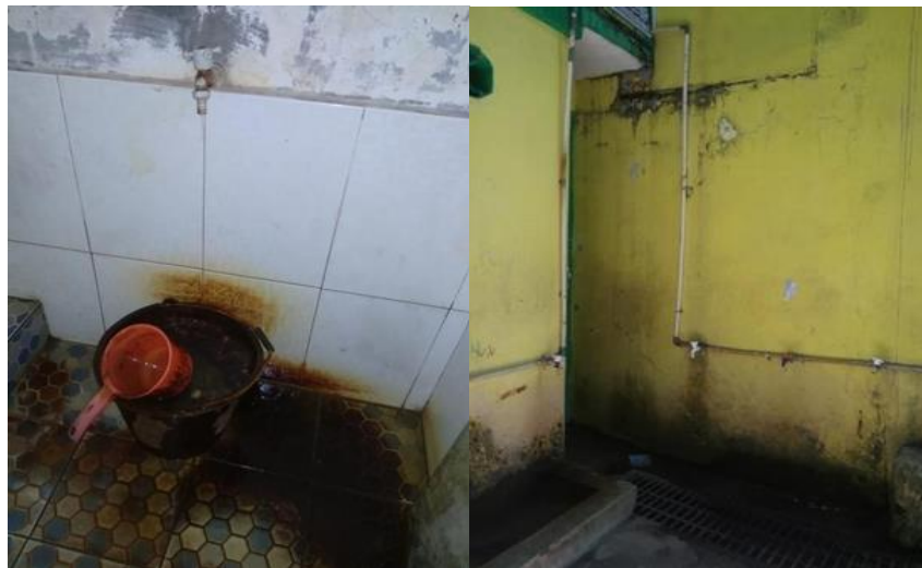
Gambar 1. Kondisi kamar mandi di MTS Amal Saleh yang tidak layak dan tidak higienis
