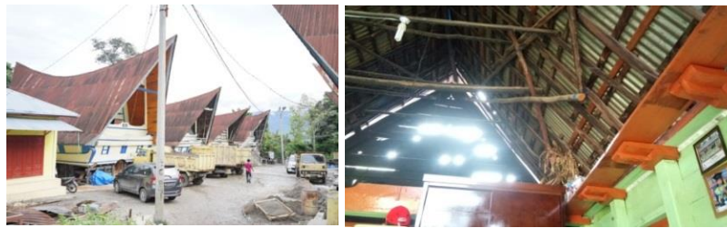
Gambar. 4. Kerusakan Pada Rumah Tradisional Batak Huta Naibaho (Sumber : Analisa Pribadi)
