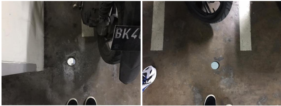
Gambar 19. titik floor drain di area parkir sepeda motor
